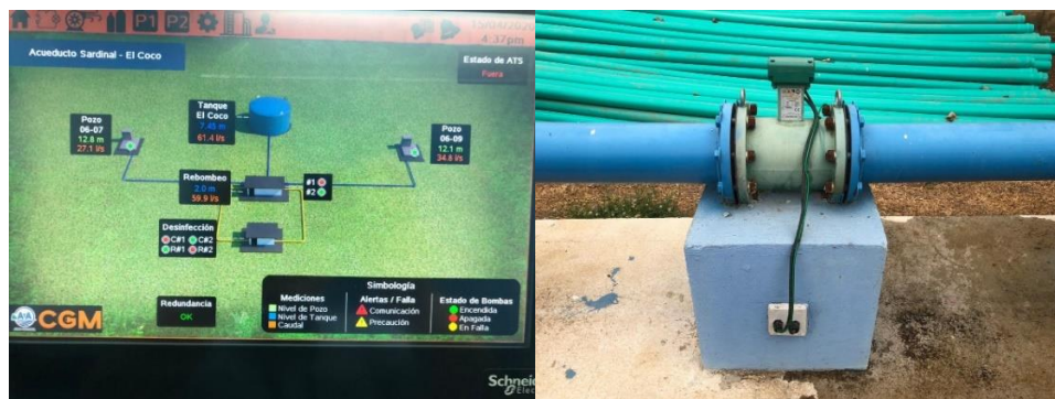
Control de caudales en en los pozos de Sardinal: Pozo 06-07 y Pozo 06-07
