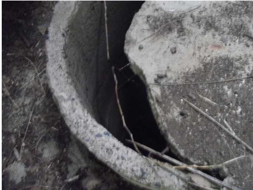
Figura 96: Pozos expuestos y abandonados son el principal riesgo a la contaminación que presenta la unidad Hidrogeológica Uvita
