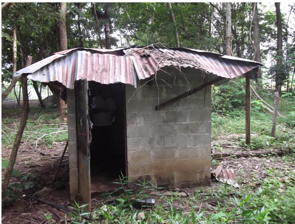
Figura 97: Pozo abandonado con infraestructura colapsada.
