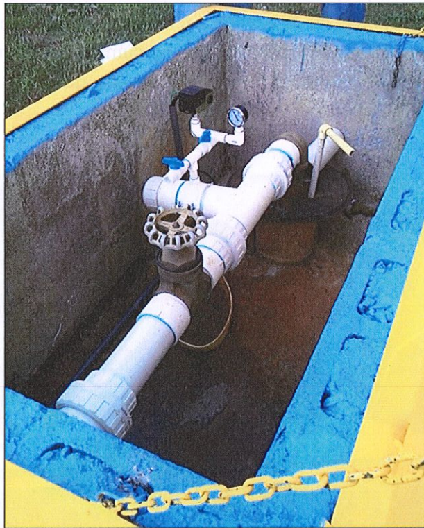
Figura 6: Fotografía del pozo AZ-77 (Los Llanos 1) de la ASADA ASA 5.
