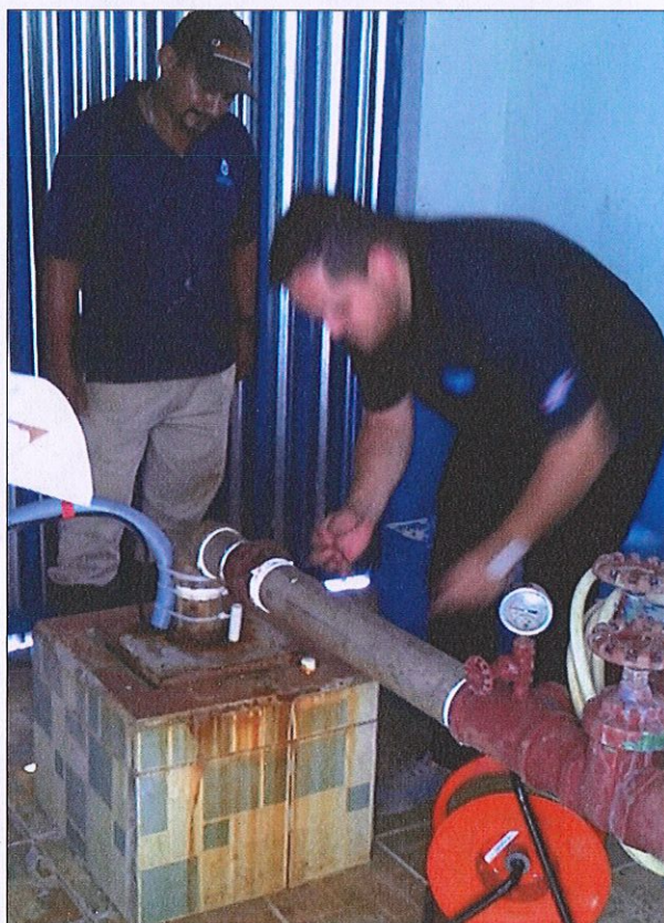
Figura 21: Fotografía del pozo SJ-2 de la ASADA Pavón.
