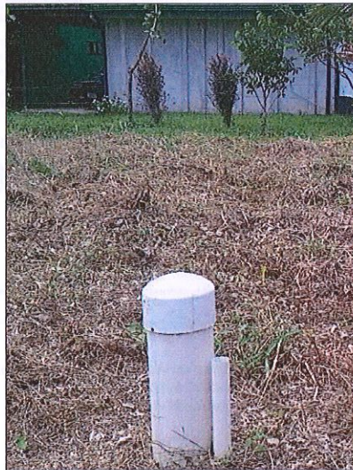
Figura 36: Fotografía del pozo 1 de la ASADA Chambacú.
