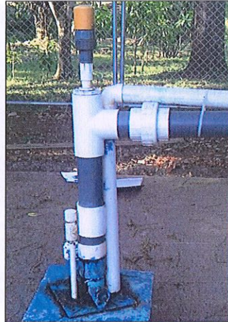
Figura 31: Fotografía del pozo 3 de la ASADA El Parque
