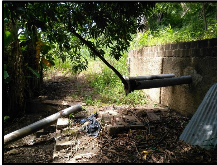
Figura 3. Tercera toma de agua encontrada en el sitio perteneciente al expediente 4858 a nombre de Granos del Pacifico S.A.
