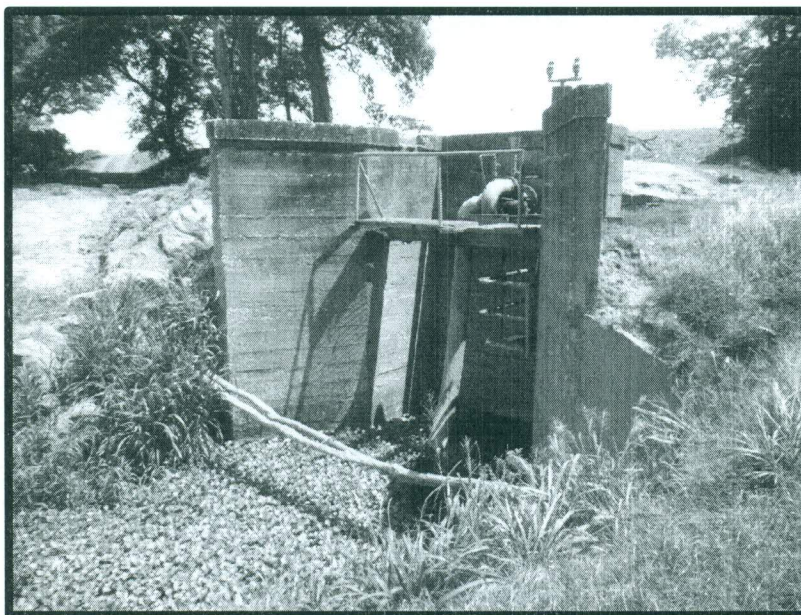
Figura 2. Sistema de bombeo de la toma de aprovechamiento de agua conocida como "Caimito" con fecha 17/05/2016.
