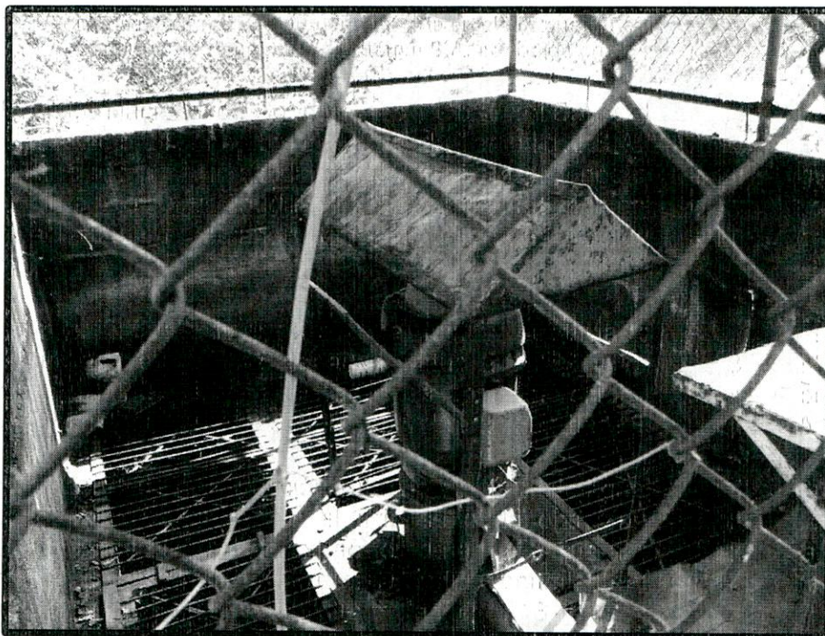
Figura 17. Décima sexta toma de agua encontrada en el sitio perteneciente al expediente 5558 a nombre de Hacienda Tempisque S.A. conocida como "Plazuela"
