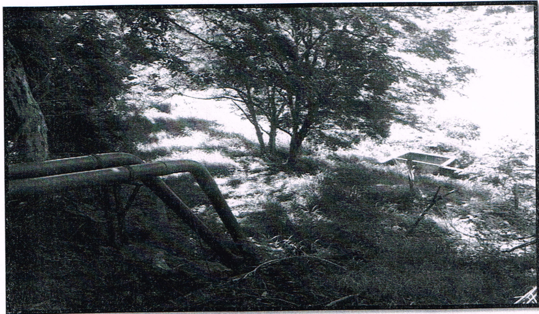
Figura 1. Primera toma de agua encontrada en el sitio perteneciente al expediente 13474 a nombre de Inmobiliaria Costa Alegre S.A.
