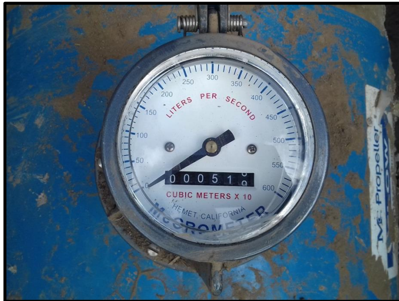
Figura 23. Flujómetro ubicado en la vigésima primera toma de agua encontrada en el sitio perteneciente al expediente 2316 a nombre de Central Azucarera Tempisque S.A. conocida como “Guayabito”.
