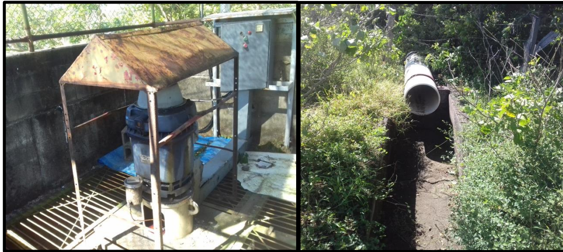
Figura 17. Décima sexta toma de agua encontrada en el sitio perteneciente al expediente 5558 a nombre de Hacienda Tempisque S.A. conocida como “Plazuela”
