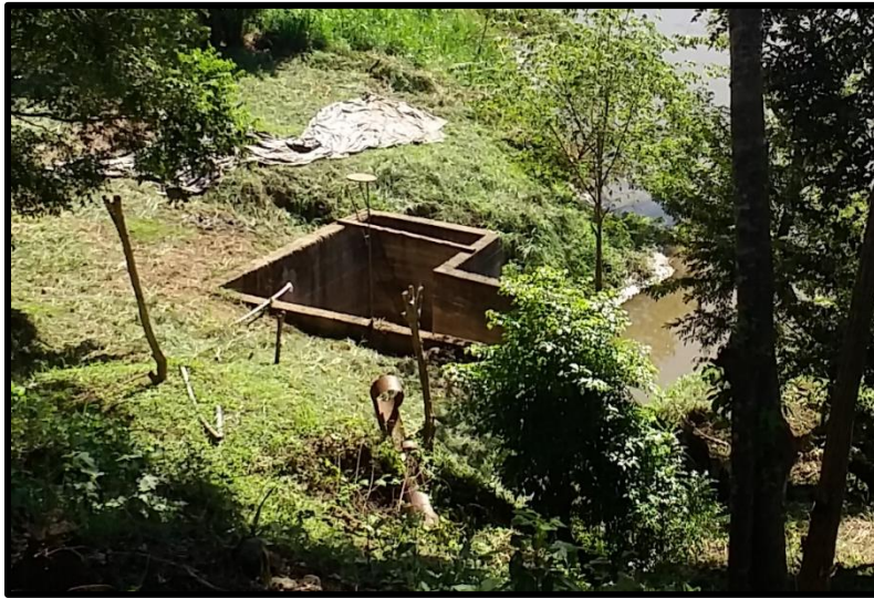
Figura 1. Primera toma de agua encontrada en el sitio perteneciente al expediente 13474 a nombre de Inmobiliaria Costa Alegre S.A.
