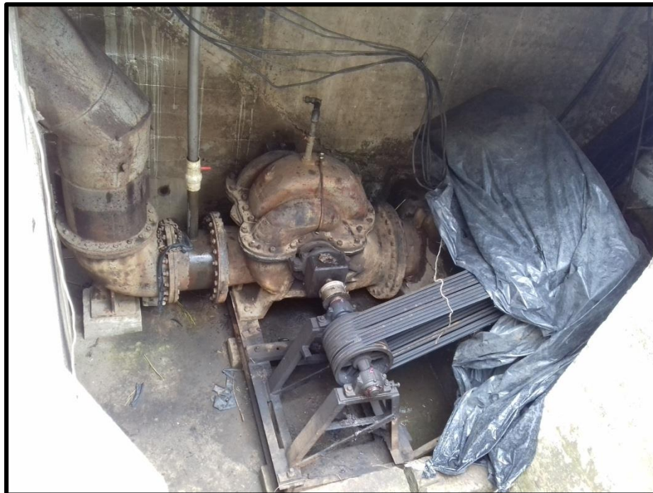
Figura 1. Primera toma de agua encontrada en el sitio perteneciente al expediente 13474 a nombre de Inmobiliaria Costa Alegre S.A.
