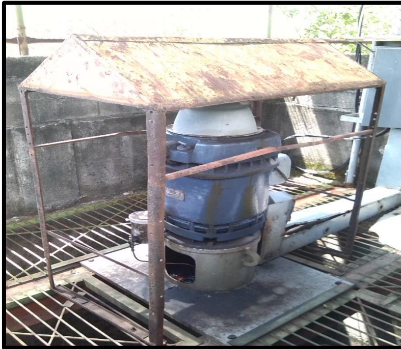
Figura 17. Décima sexta toma de agua encontrada en el sitio perteneciente al expediente 5558 a nombre de Hacienda Tempisque S.A. conocida como “Plazuela”
