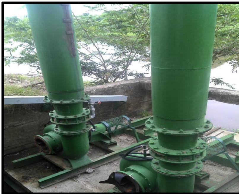
Figura 14. Décima Tercera toma de agua encontrada en el sitio perteneciente al expediente 4844 y 5165 a nombre de Central Azucarera Tempisque S.A. conocida como “Románticas”
