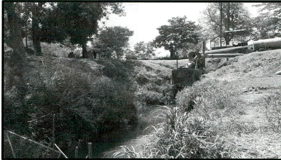
Figura 19. Sistema de bombeo de la toma de aprovechamiento de agua conocida como “Guayabito” concesionada por CATSA con fecha 27/04/2016.
